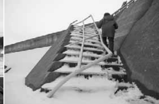
津波で曲げられた防潮堤の手すり
