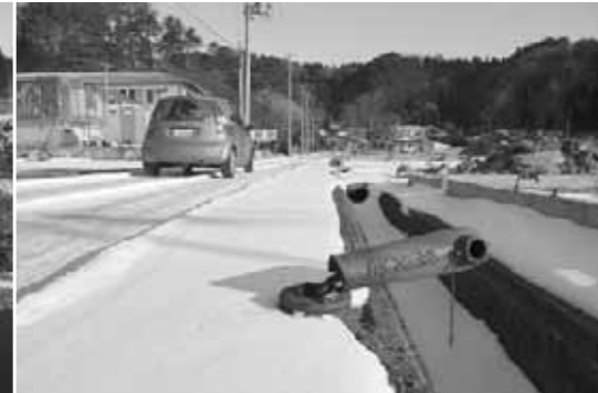
曲げられた消火栓
