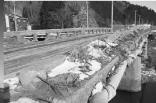
壊された橋の欄干
