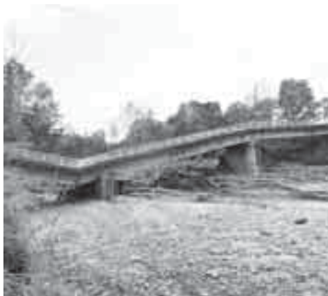
上芽室橋の崩落により交通網が寸断した。
